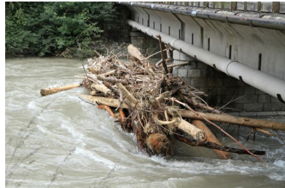
(b) „Gefahr, die der Fluss anschwemmt“, Totholz an einem Brückenpfeiler, Quelle: Tiroler Tageszeitung Online, 2022
