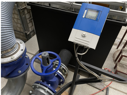
Drossel und Übergang Zulaufbehälter
