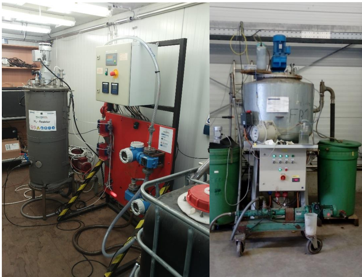
Abbildung 3-3: Halbtechnische Versuchsanlage mit Wasserstoffreaktor (links) und Methanreaktor (rechts)
