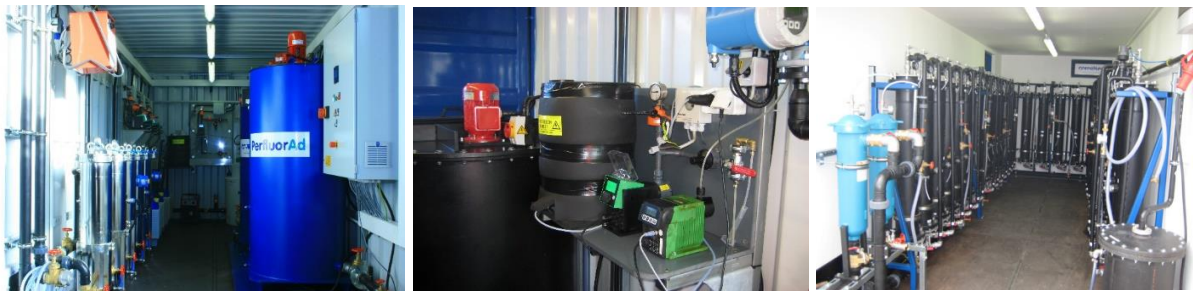
Abbildungen 3.3-1 a, b, c: a) In Normcontainer eingebaute Pilotanlage (rechts Rührreaktor; links Beutelfilter); b) mit Heizmantel ausgestattete Dosiervorlage für Fällmittel (schwarzer Behälter in Bildmitte) einschl. Dosierpumpen (vorne) und c) parallel geschaltete Säulenkolonnen zur simultanen Aufnahme von Durchbruchskurven für unterschiedliche Adsorber-Materialien (Hersteller: Cornelsen Umwelttechnologie GmbH)
