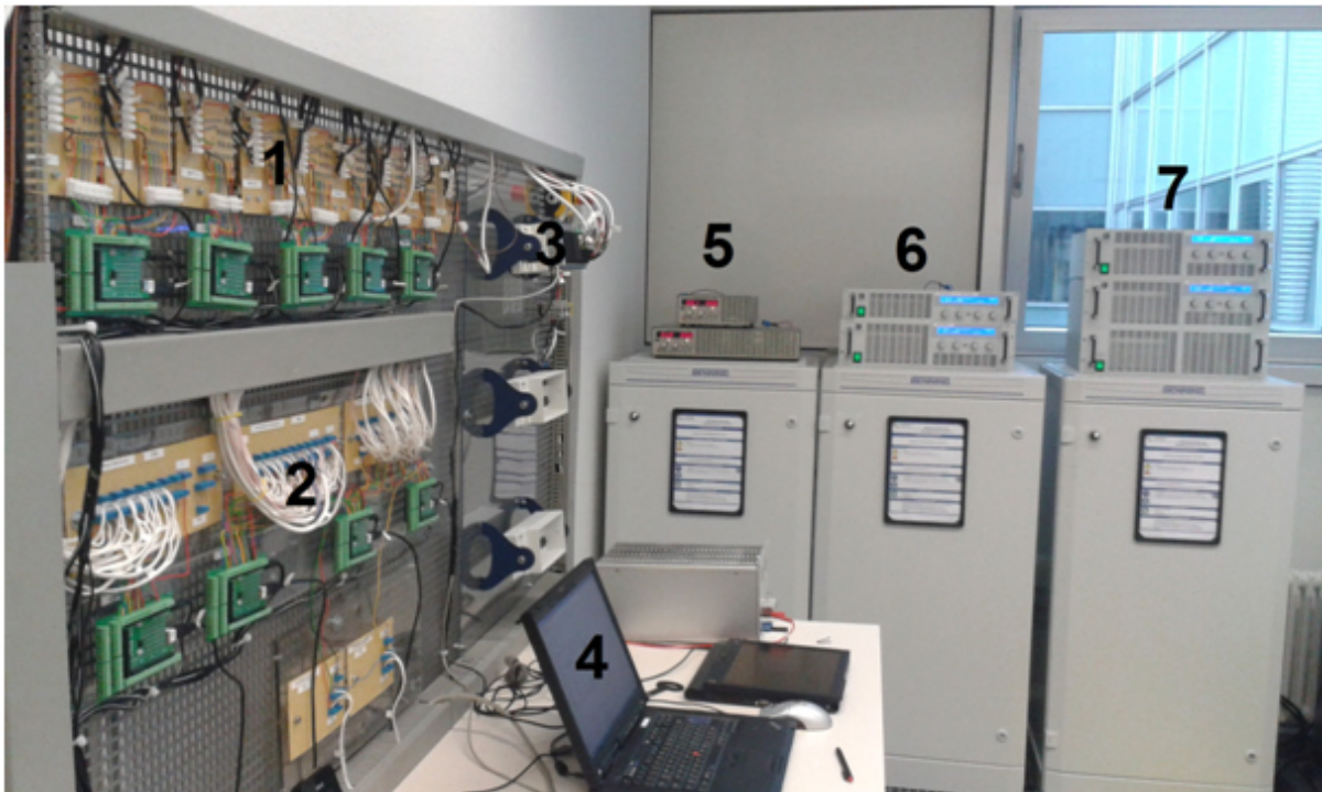
Bild 2: Überwachung und Steuerung der LFP-Batteriezellen
